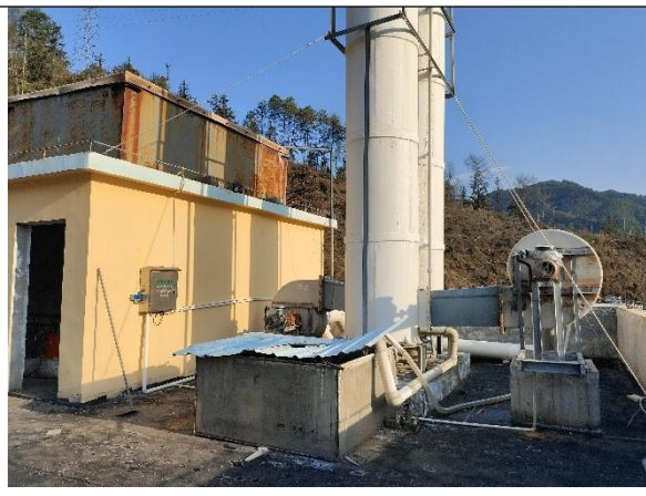
照片 18 尾气洗涤塔
