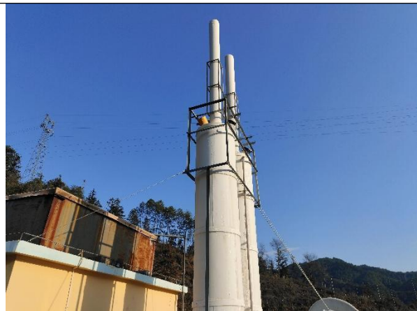
照片 19 尾气洗涤塔排气筒
