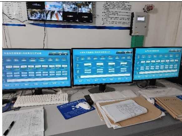
照片 20 DCS 控制室
