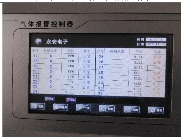
照片 21 氢气和氯气检测控制器
