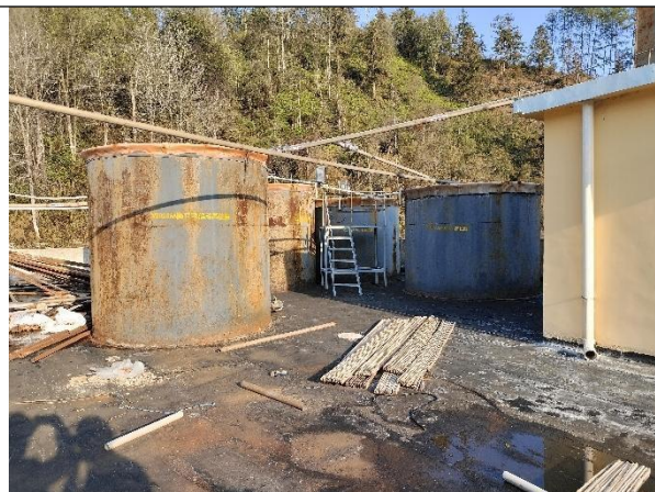
照片 17 高氯酸钾车间屋顶上的高位槽
