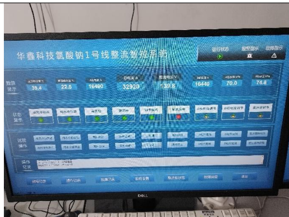
照片 23 整流控制系统
