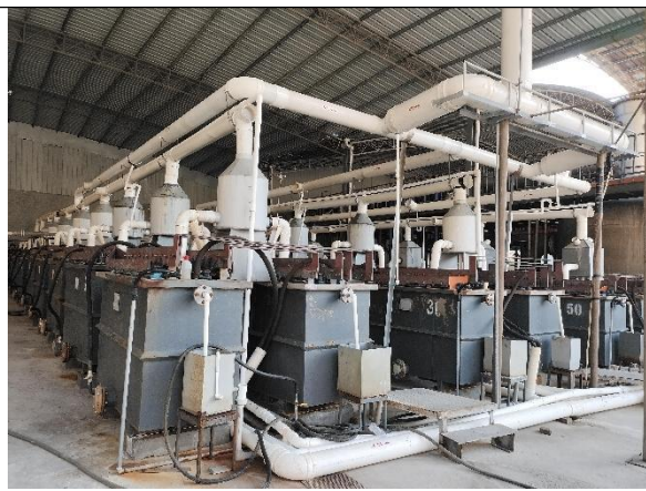
照片 2 1#线电解槽
