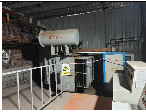
照片 4 整流变压器
