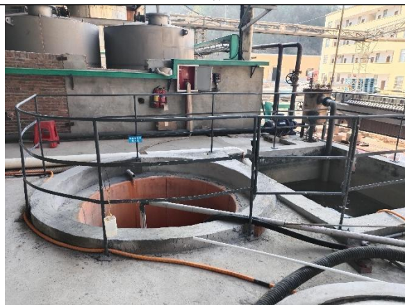
照片 10 高氯酸钠溶液槽
